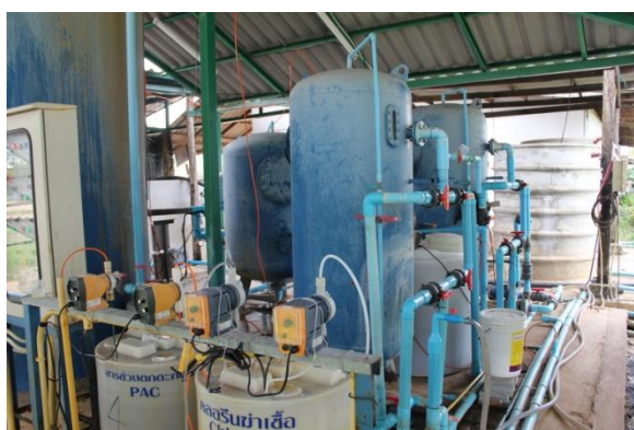
ภาพที่ 26 ระบบกรองน้ำก่อนเข้าใช้ภายในโรงเรือน
